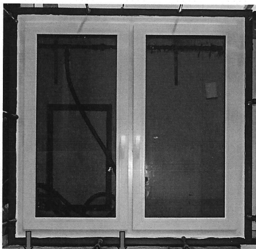
wyciek spod skrzydła
